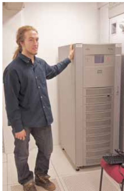
Bilden visar en utrustning för avbrottsfri kraft i en hall med dataservrar.
